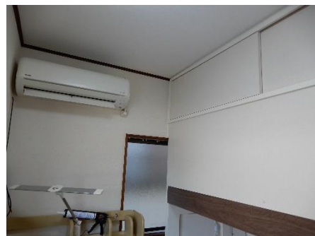
エアコン1台を引き違い窓を開けて共有
